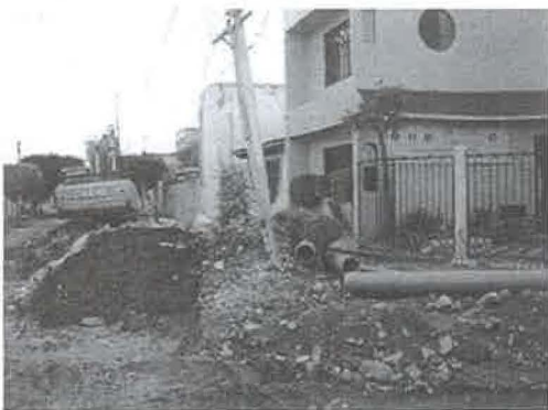
Calle Fray T. de Benavente - Olmos a calle Aparicio (se encuentra en terracería), faltan instalaciones de gas, agua potable pluvial, banquetas y quarniciones
