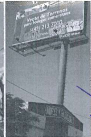
ANUNCIO ANU2017-00664 EL 20/02/2018, CON PINTURA DESLAVADA AL EXTERIOR DE LA EDIFICACIÓN, VISTA DEL 20/02/2018.
